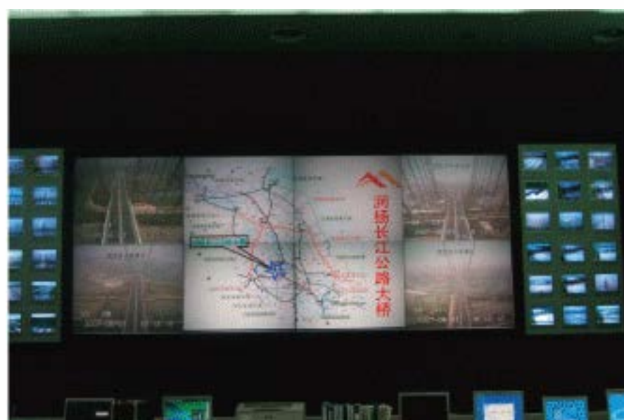
桥梁结构安全在线监测
