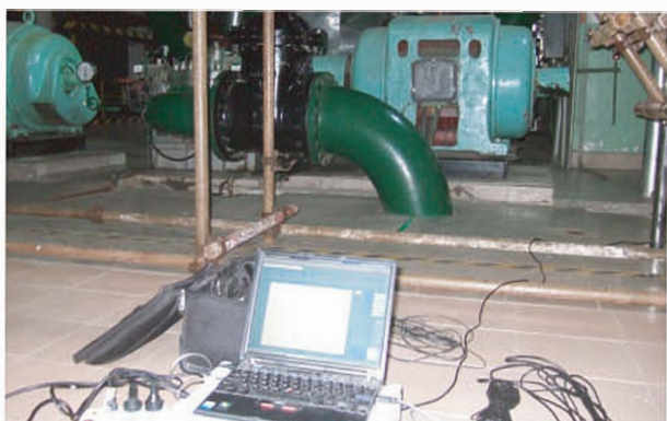
秦山一期核电凝结水泵管道振动 (2008年05月31日)
