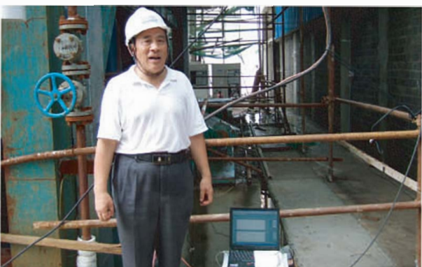
洪泽新能源电厂振动炉排测试 (2007年08月04日)
